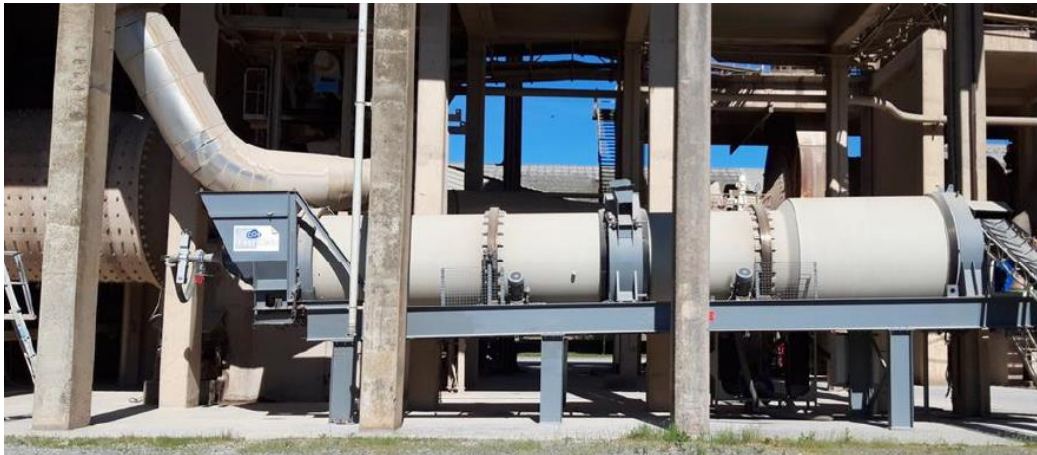
Figure 4. Procédé à tambour rotatif (usine Vicat de Créchy)
