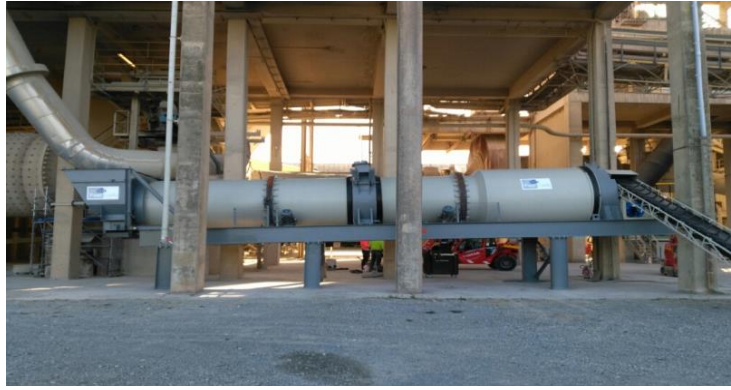
Figure 19 Pilote FastCarb – Tambour sécheur, usine Vicat de Créchy (Allier)
